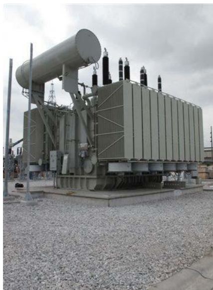
Figura 3. Transformador de potencia. Fuente. (CELEC EP, 2010)
