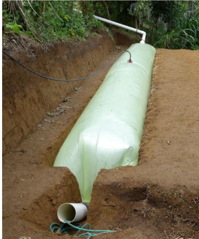
Figura 6 Biodigestor tubular de plástico Nota: Adaptada de (Martí Herrero, 2019)
