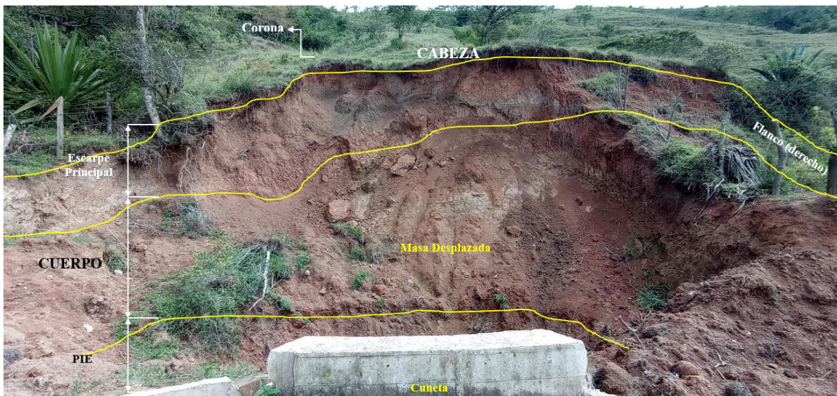
Figura 61. Deslizamiento No.4 en la vía Amaluza-Bellavista
