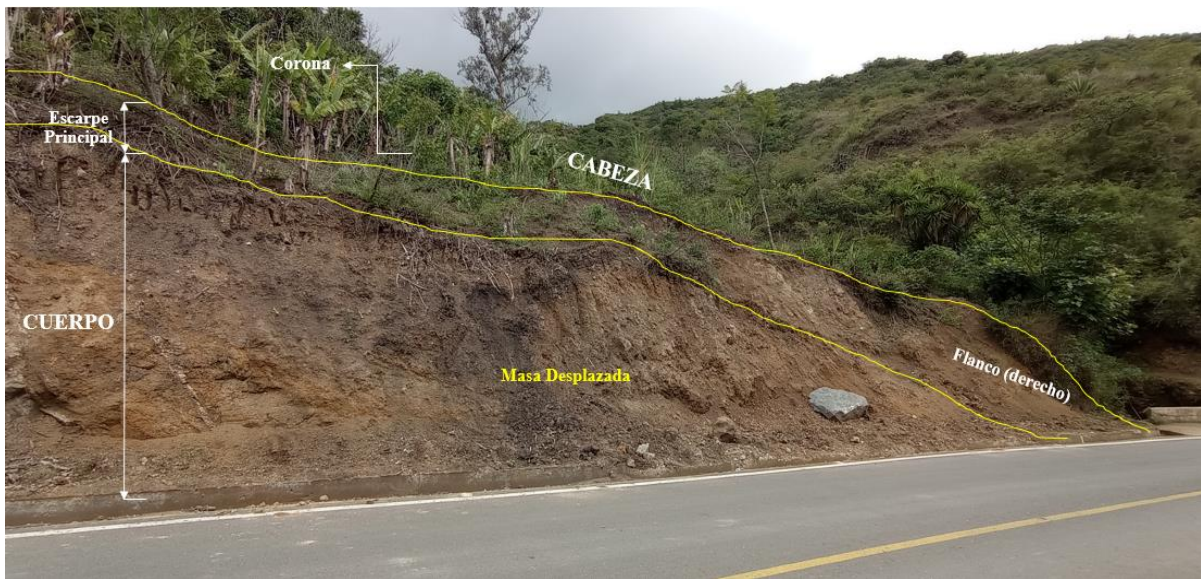
Figura 60. Deslizamiento No.3 en la vía Amaluza-Bellavista
