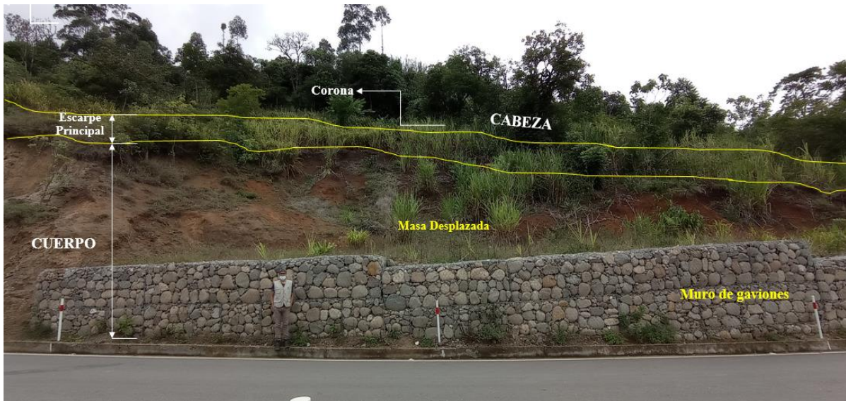
Figura 59. Deslizamiento No.2 en la vía Amaluza-Bellavista
