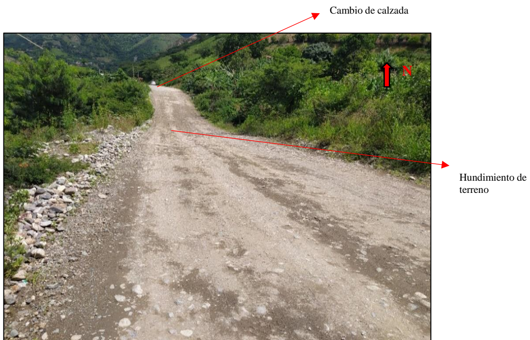
Fotografía 18: Hundimiento en la vía de primer orden
