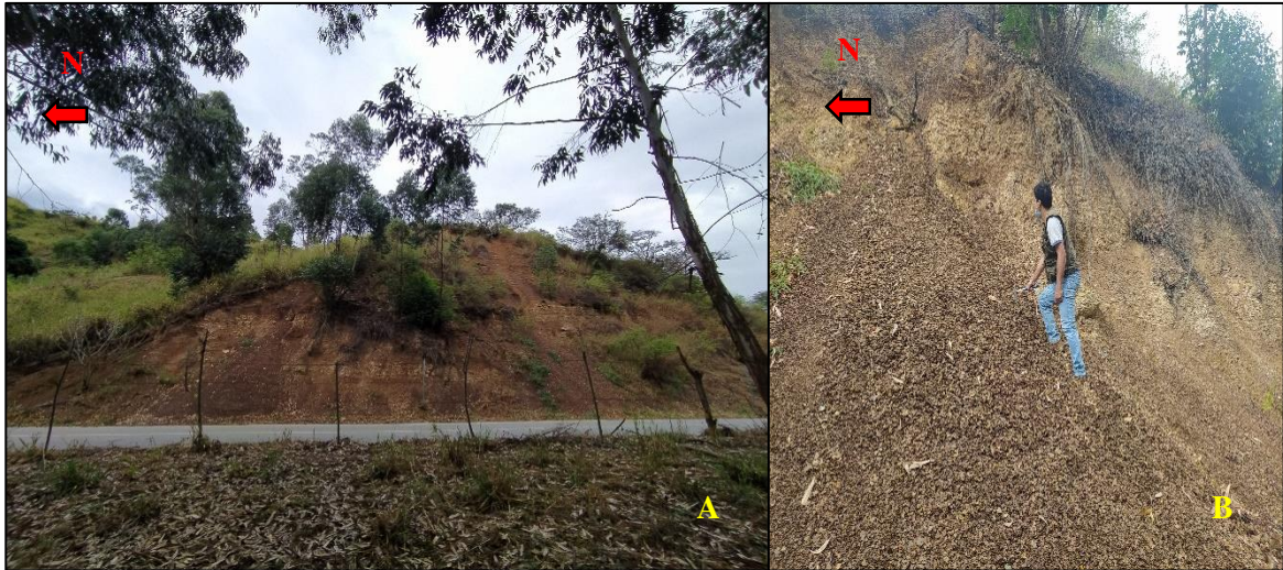
Fotografía 23: Deslizamiento #2, A (Vista frontal), B (Toma de datos)
