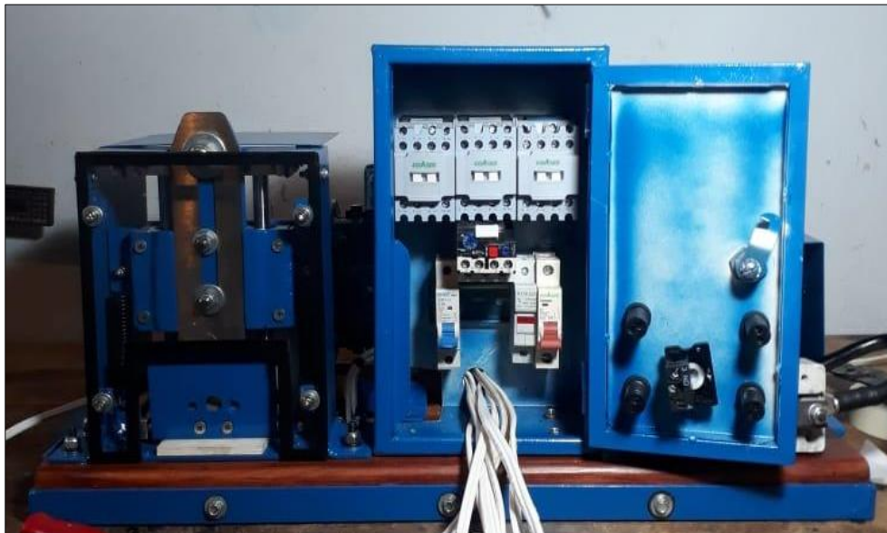
Figura 62. Cableado del tablero de control. Fuente: Propia.
