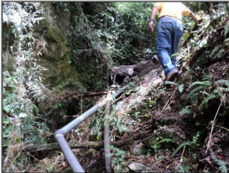
Ilustración 12. Captación de Quebrada Quillollacu
