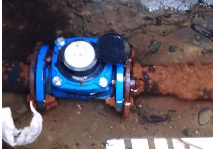
Ilustración 14. Antiguo medidor colocado por (PMAP)No funcional
