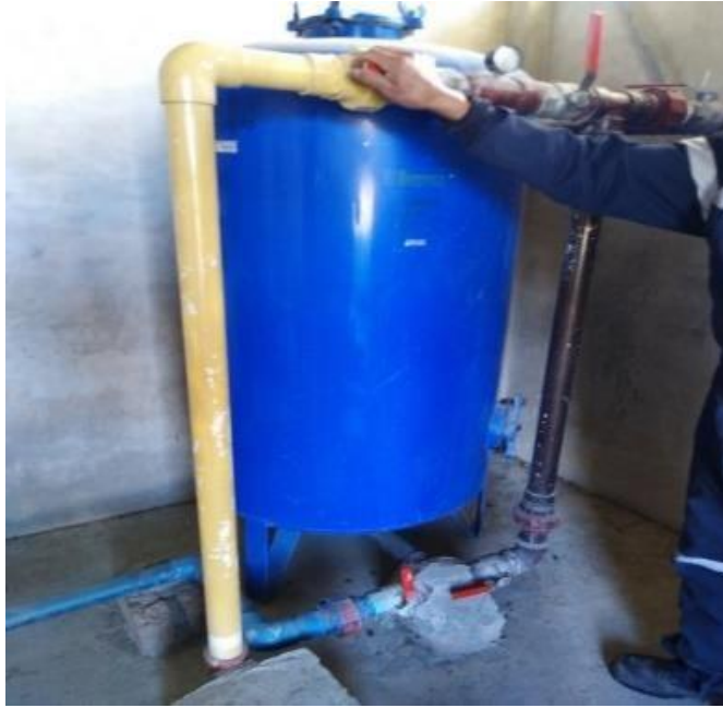
Ilustración 15. Tanque con filtro para el proceso de cloración
