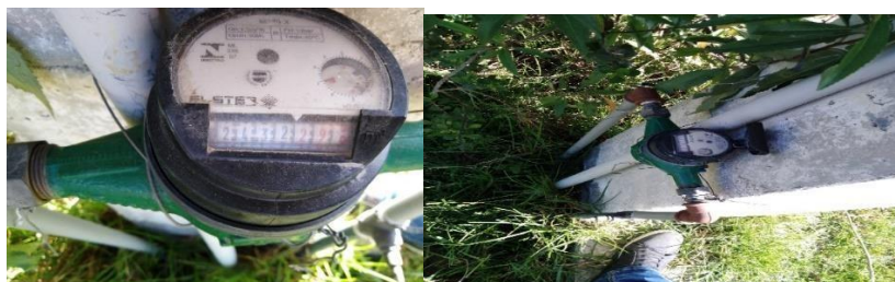
Ilustración 16. Medidor Edificio Ex-Cater
