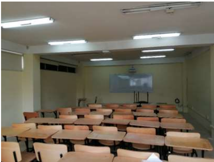
Figura 62 Estado actual del sistema de iluminación de aula del bloqueA3 Fuente: Instalaciones de la FEIRNNR del bloque A3
