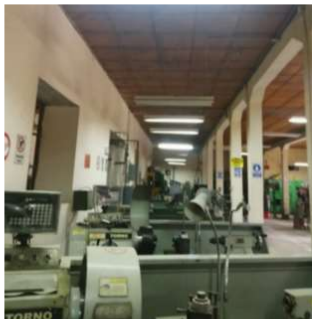
Figura 61 Estado actual de luminarias del taller mecánico Fuente: Talleres de la FEIRNNR
