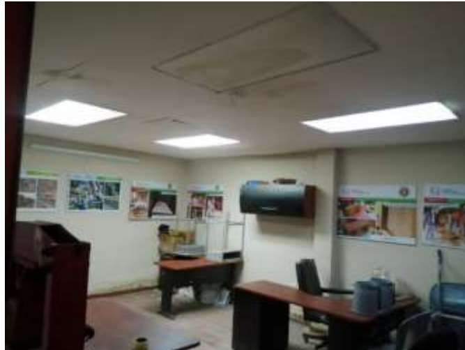
Figura 60 Estado actual de luminaria del laboratorio de materiales de construcción Fuente: Oficinas de la FEIRNNR
