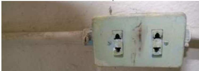
Figura 22 Foto tomacorriente en mal estado Fuente: Propia
