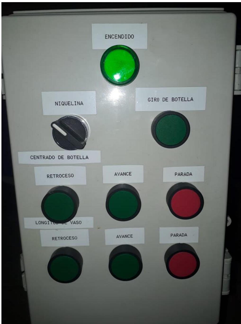
Anexo 20. Tablero de control.
