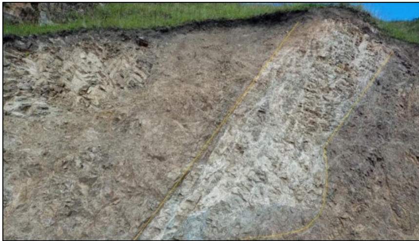
Fotografía 21. Falla, ubicada en la vía de tercer orden que conduce al río Gualiel
