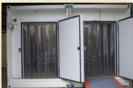
Figura 37. Cámara de refrigeración
