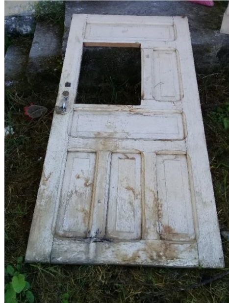
Imagen 80. Espejo, F. 2019. Intervención con herramientas para corte sobre madera. Sustracción de ventanas en la puerta. [Fotografía].
