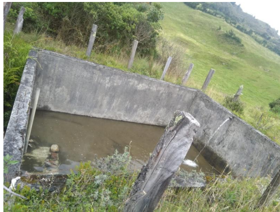
Figura 27. Tanque reservorio que abastece de agua al predio "La Dolorosa".
