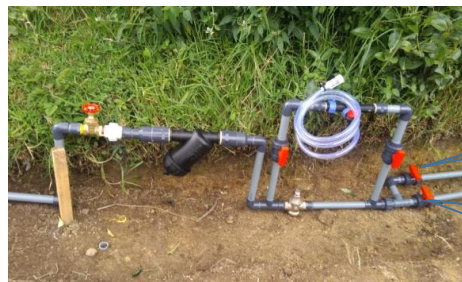
Figura 26. Esquema y fotografía del cabezal de riego instalado.
