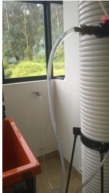
Figura 87. Conexión de la línea de carga de agua hacia la reserva a una red en el laboratorio.
