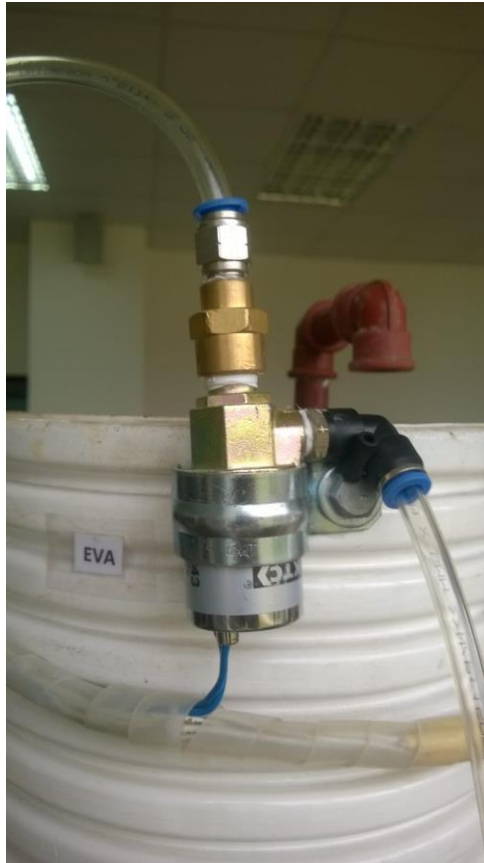
Figura 66. Conexión de la tubería de aire del compresor a la electroválvula EVA. Fuente: Autor.
