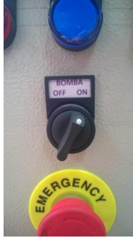
Figura 94. Puesta en marcha el tablero de control para el funcionamiento del sistema de bombeo.
