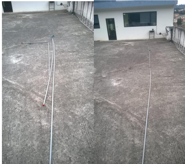
Figura 59. Tubería de descarga para cada altura (2m, 4m, 6m, 8m, 10m). Fuente: Autor.
