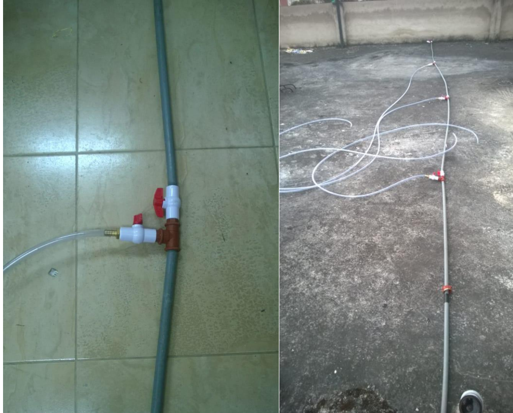
Figura 72. Tubería de descarga para cada altura (2m, 4m, 6m, 8m, 10m). Fuente: Autor.
