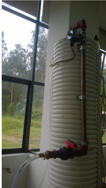
Figura 76. Válvula de cierre rápido de emergencia para sensores SND1 SND2 Y EVC. Fuente: Autor.
