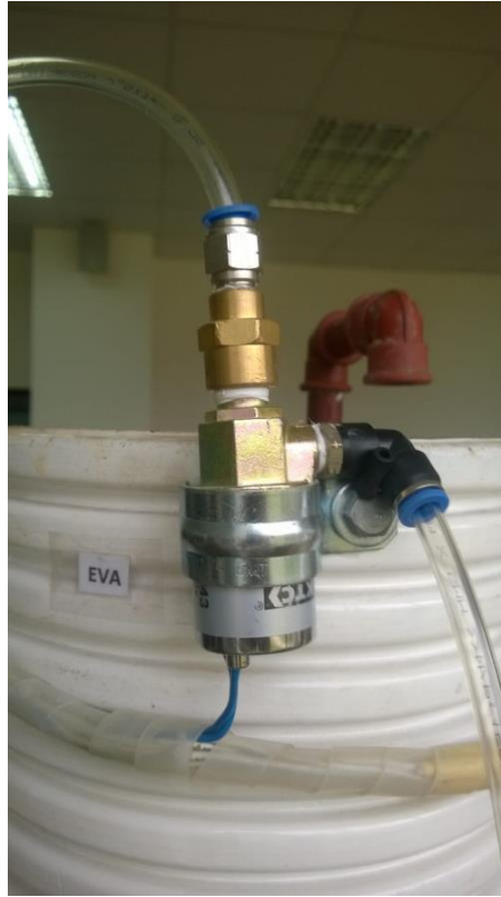
Figura 106. Conexión de la tubería de aire del compresor a la electroválvula EVA. Fuente: Autor.
