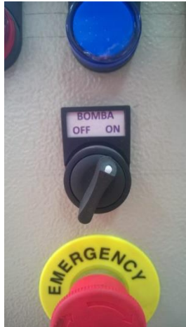
Figura 80. Puesta en marcha el tablero de control para el funcionamiento del sistema de bombeo.
