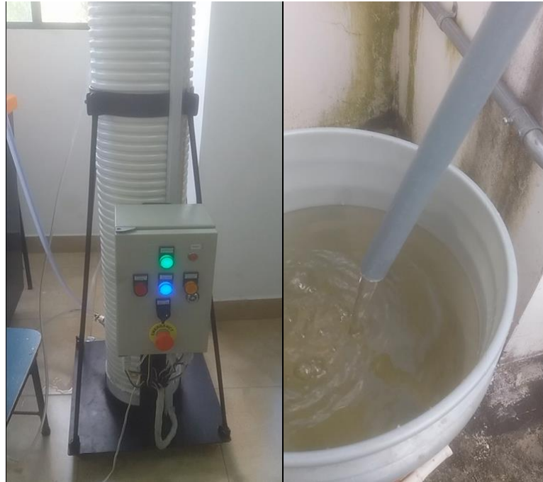
Figura 49. Sistema de bombeo en descarga. Fuente: Autor.
