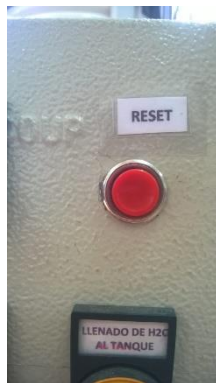
Figura 81. Pulsador NO para resetear el sistema de bombeo y reanudar los ciclos. Fuente: Autor.
