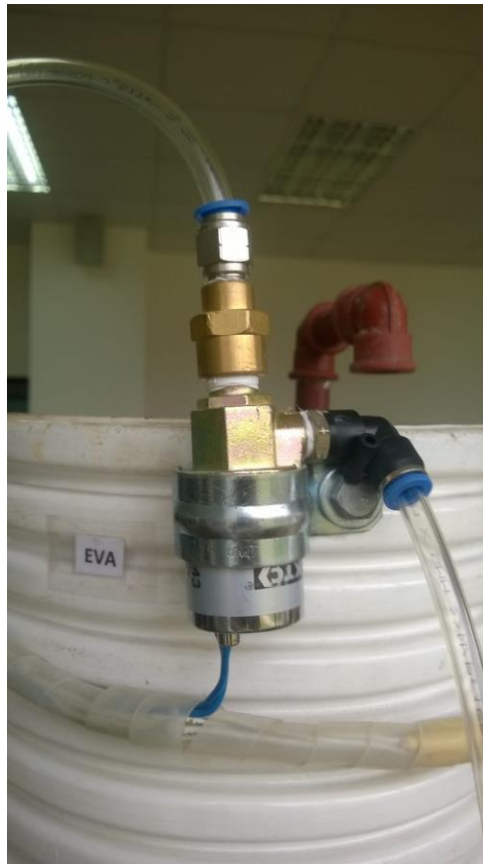
Figura 79. Conexión de la tubería de aire del compresor a la electroválvula EVA. Fuente: Autor.
