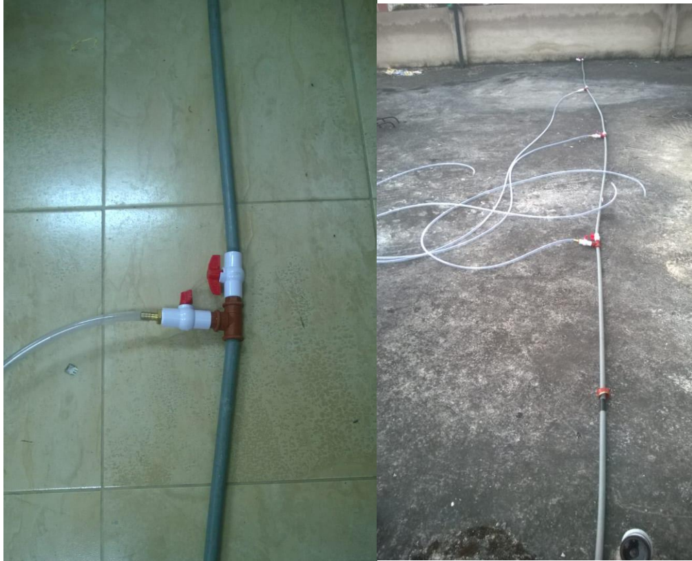
Figura 99. Tubería de descarga para cada altura (2m, 4m, 6m, 8m, 10m). Fuente: Autor.
