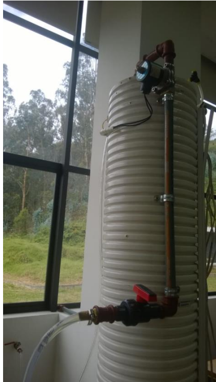
Figura 103. Válvula de cierre rápido de emergencia para sensores SND1 SND2 Y EVC. Fuente: Autor.
