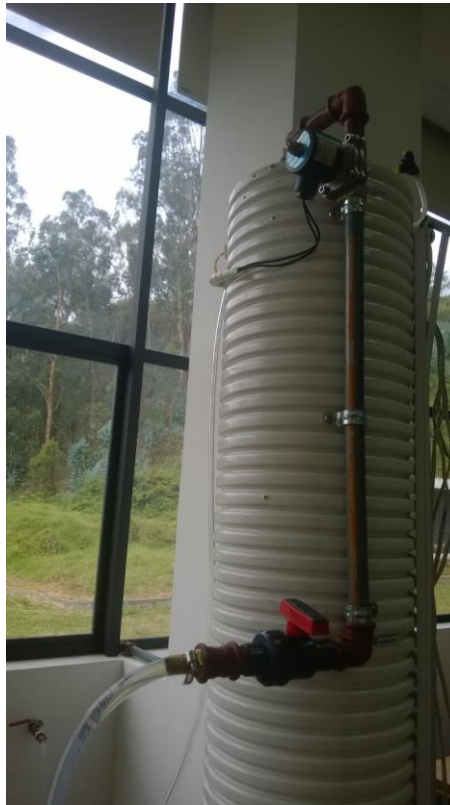
Figura 89. Válvula de cierre rápido de emergencia para sensores SND1 SND2 Y EVC. Fuente: Autor.
