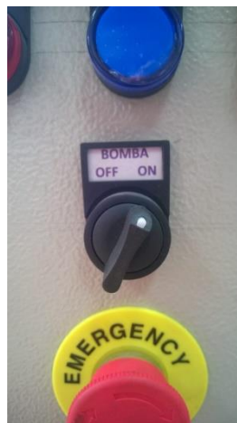
Figura 67. Puesta en marcha el tablero de control para el funcionamiento del sistema de bombeo.
