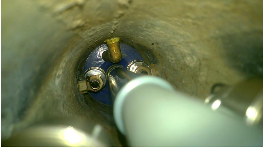
Figura 42. Ensamble de sensores SNA1, SNA2, SNB1, SNB2, para el control de carga y descarga del fluido en la parte interna de la cámara. Fuente: Autor.
