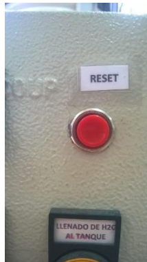
Figura 68. Pulsador NO para resetear el sistema de bombeo y reanudar los ciclos. Fuente: Autor.
