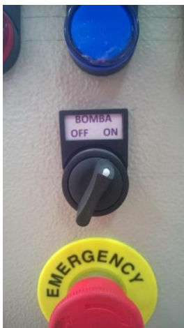
Figura 107. Puesta en marcha el tablero de control para el funcionamiento del sistema de bombeo. Fuente: Autor.
