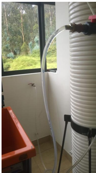
Figura 101. Conexión de la línea de carga de agua hacia la reserva a una red en el laboratorio.
