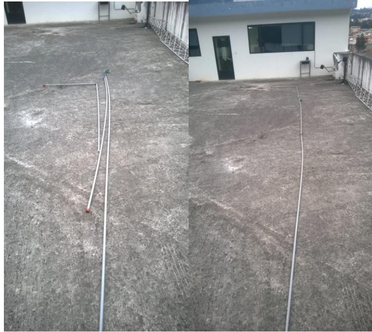
Figura 85. Tubería de descarga. Fuente: Autor.
