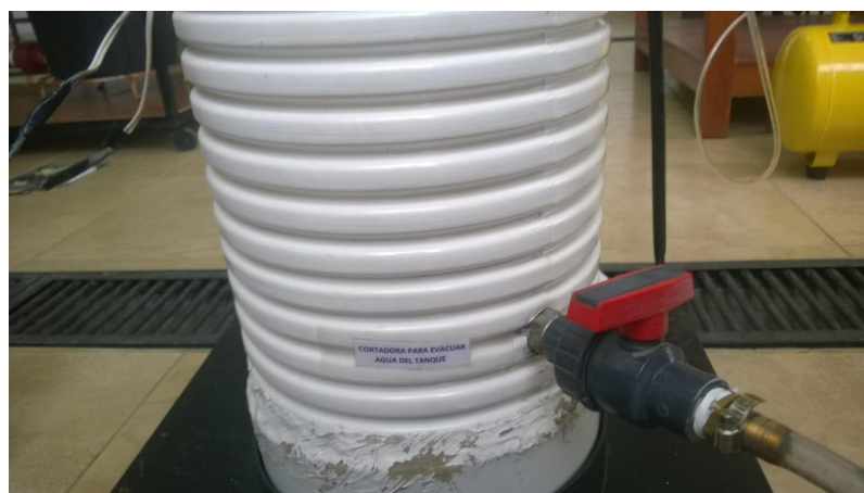
Figura 86. Válvula de cierre rápido para purgar el agua de la reserva. Fuente: Autor.
