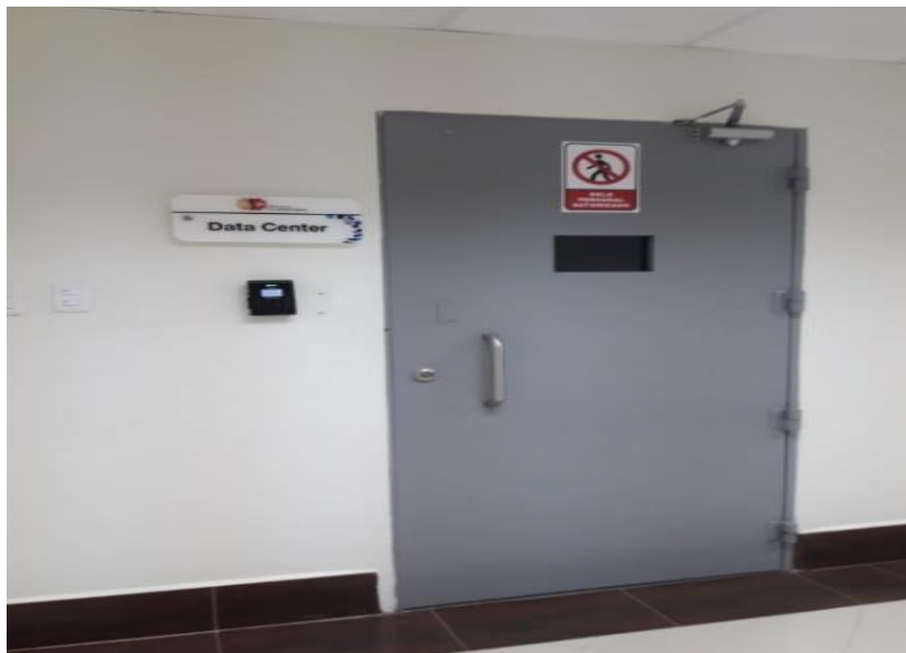
Figura 6. Datacenter (Imagen Propia).
