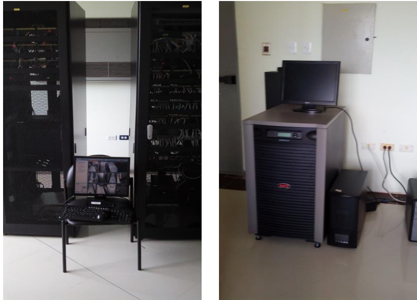
Figura 10. Equipos del Datacenter (Imagen Propia).
