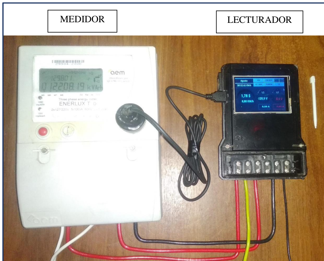
Figura 55. Implementación final del “Prototipo de Lectorador de Energía Bifásico” .
