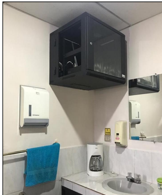
Figura 20. Imagen del rack de telecomunicaciones ubicado en un cuarto húmedo. Fuente: La Autora.
