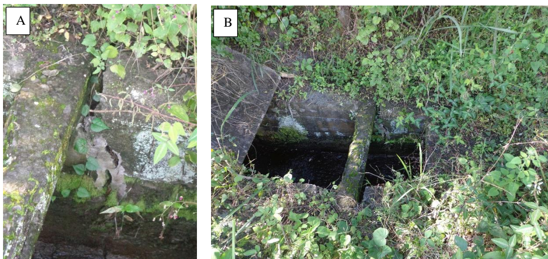
Fotografía 10. Daños en el canal A) Grietas sobre la pared; B) Fisura y musgo en la infraestructura Fuente: El Autor, 2019
