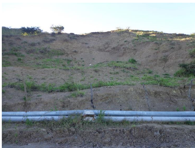
Fotografía 11. Canal de riego afectado parcialmente por un movimiento en masa Fuente: El Autor, 2019
