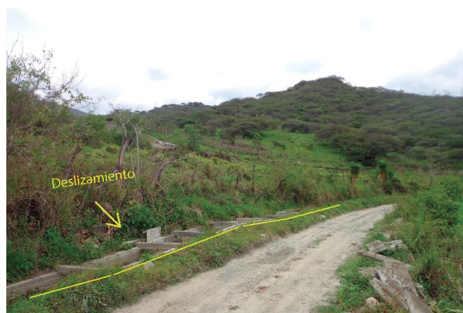
Fotografía 39. Infraestructura del canal afectado por el deslizamiento.
