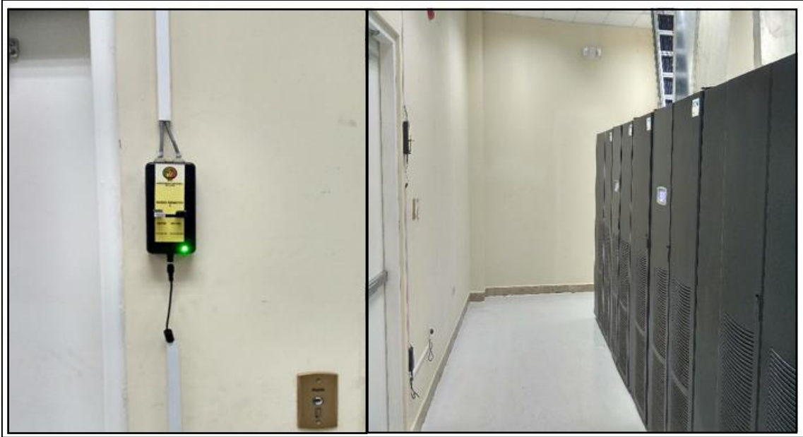
Figura 42. Nodo Remoto 1. Área de UPS. Fuente [El Autor]
