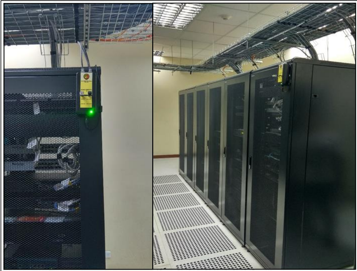
Figura 43. Nodo Remoto 2. Área Data Center. Fuente [El Autor]
