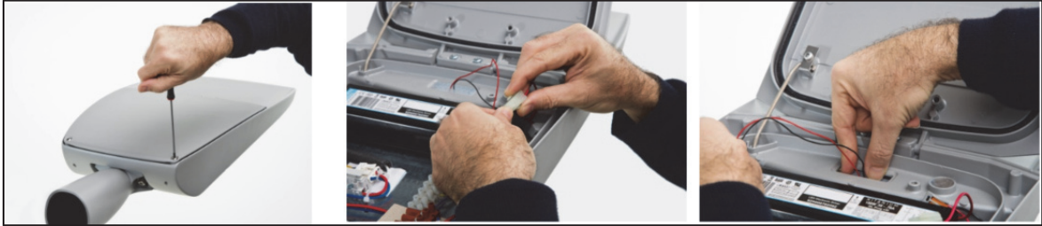
Figura 14. Controlador colocado en el interior de la luminaria, [36].
