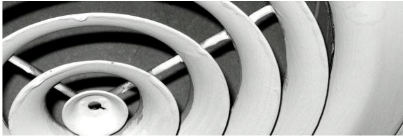
Figura 22. UPSTREAM. (2010). Ventilación mecánica [Fotografía]. Recuperado de http://upstream.cl/consultoria
