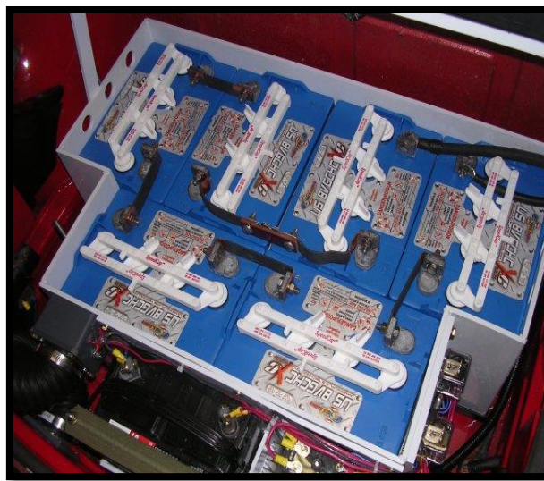
Figura 15: Banco de baterías interno
