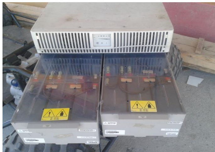
Figura 28: UPS con el banco de baterías extraídas
