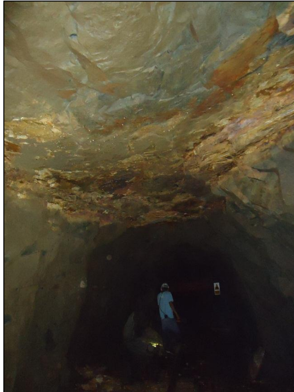
Fotografía 23. Zona de desprendimiento de material desde el techo del tramo 28
