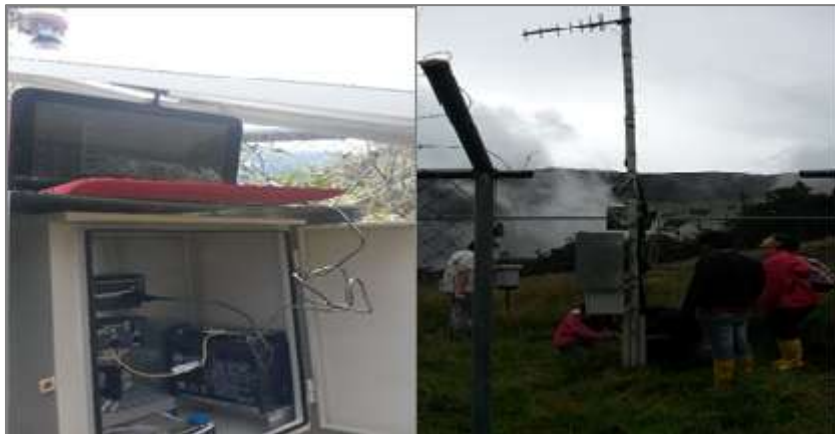
Figura 13. Descarga y mantenimiento de las estaciones el Carmen 1 y Mónica
