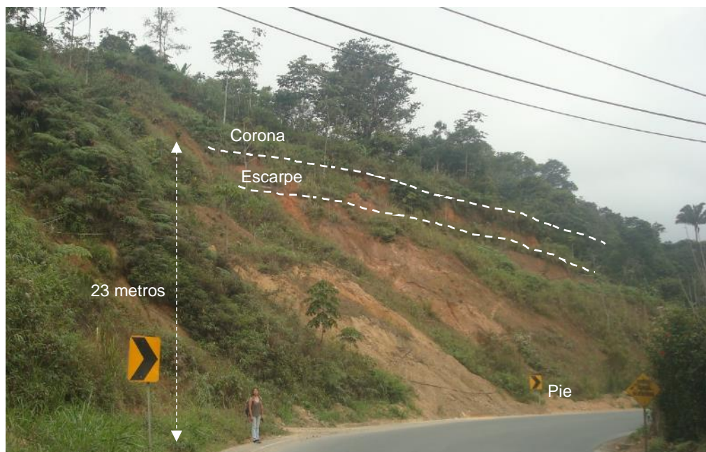
Figura 55. Deslizamiento a 1Km de Balsas Fuente: La Autora, 2017.
