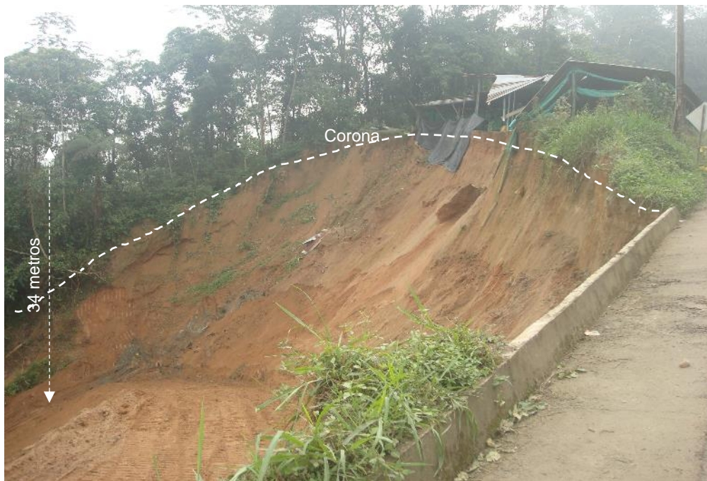
Figura 54. Deslizamiento Sector Balsas Fuente: La Autora, 2017.
