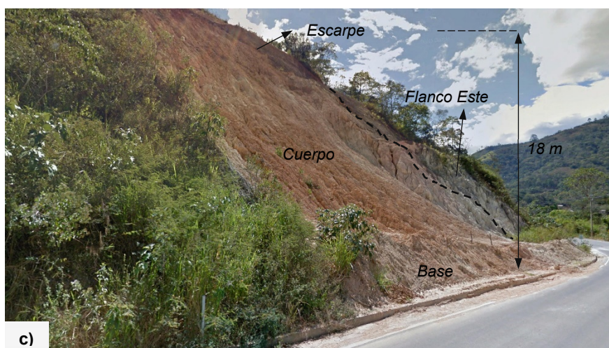
c) Deslizamiento ubicado en el sector las Peñas UTM: 650711; 9566595
