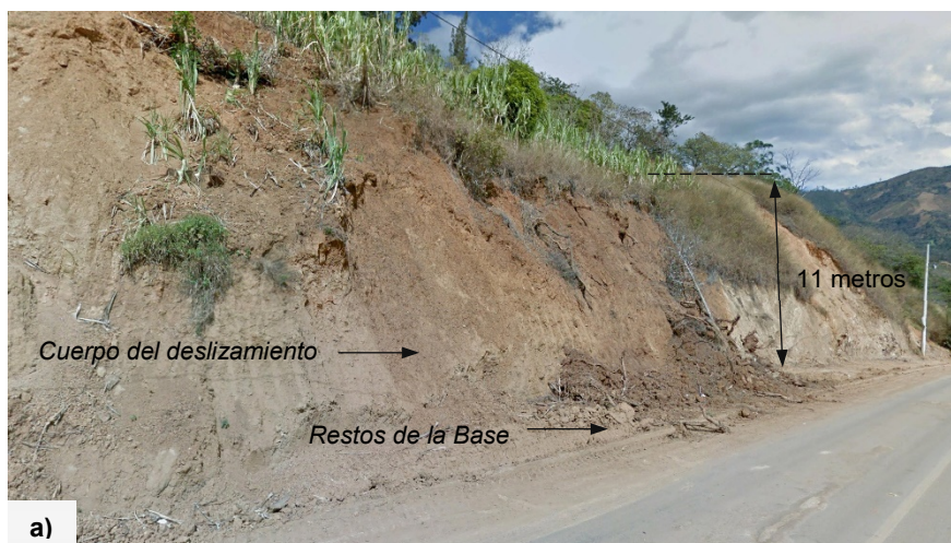
a) Deslizamiento a 200 metros del barrio la Delicia (UTM: 651061; 9564465)
