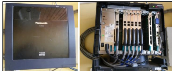
Fig. 45. Central de la facultad de Salud Panasonic KX-TDE 200. [Elaboración propia]
