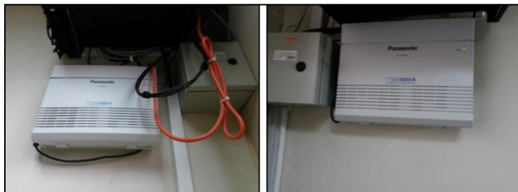
Fig. 38. Centrales de la facultad Jurídica Panasonic KX-TES 824. [Elaboración propia]
