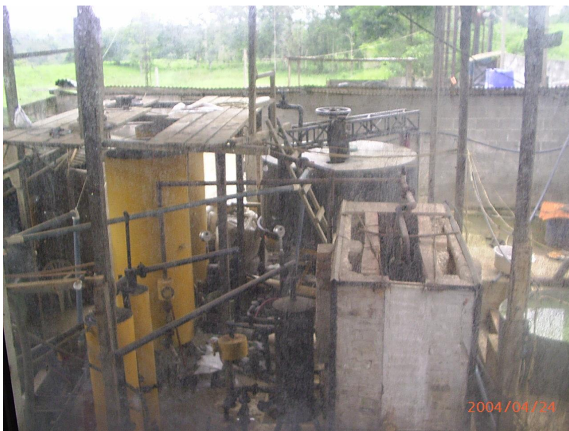
Fotografía N° 6: Planta de desorción del tipo Zadra Presurizada
