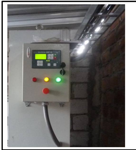
Figura 82. Pruebas de operatividad del control en el grupo electrógeno
