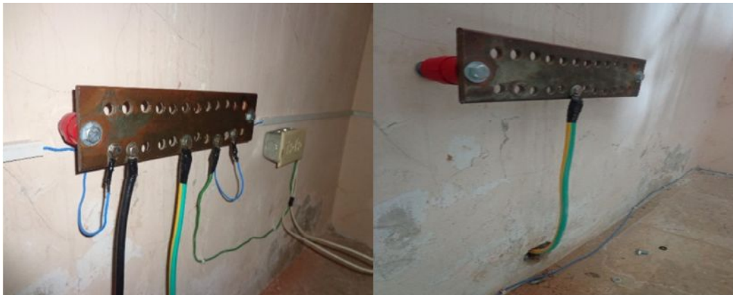
Fig. 50: Barras de puesta a tierra perforadas
