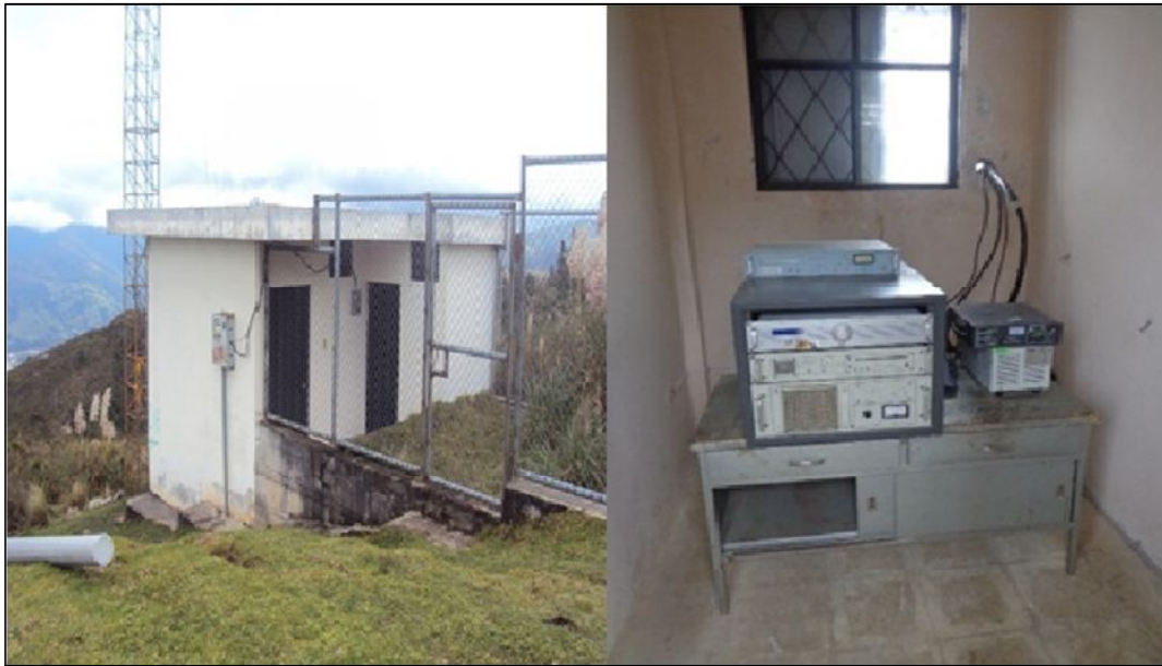
Figura .34: Estación Radio Universitaria 98.5 MHz, ubicada en el cerro Huachichambo y equipos a ser intervenidos.
