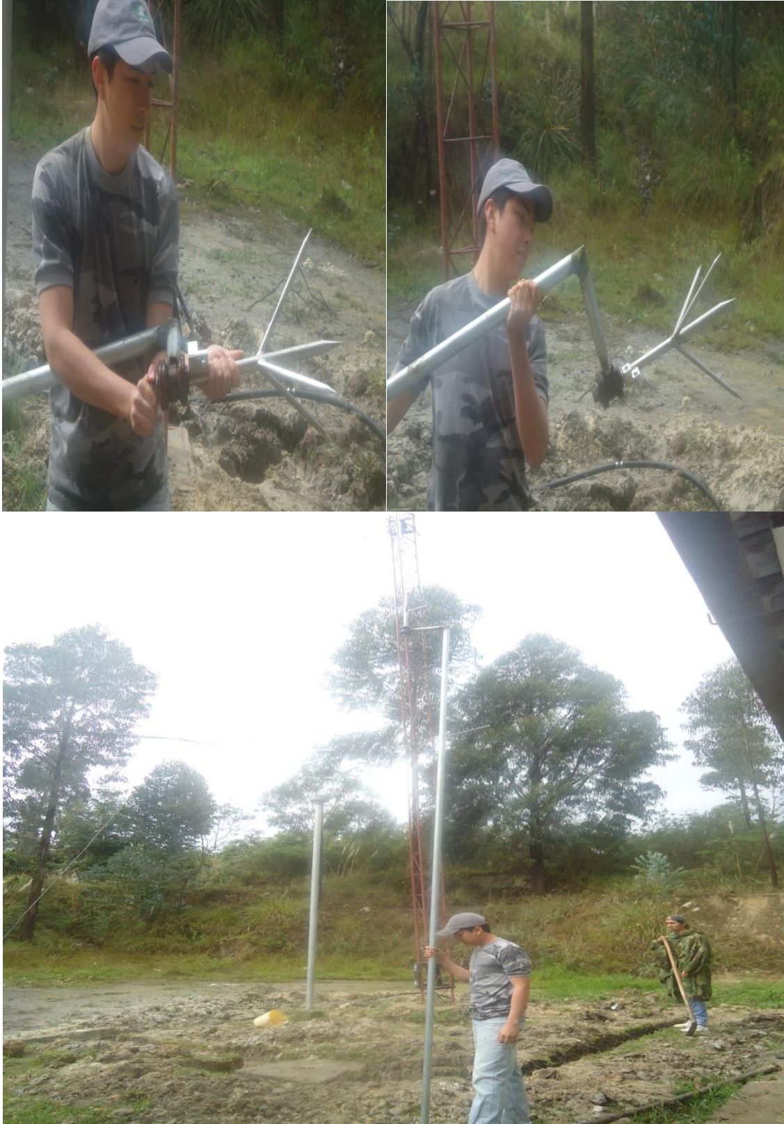
Figura. 42: Pararrayos ensamblado en su mástil
