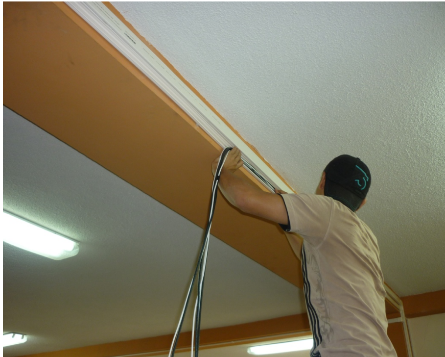
Ubicación de los cables de datos y electricidad por las canaletas
