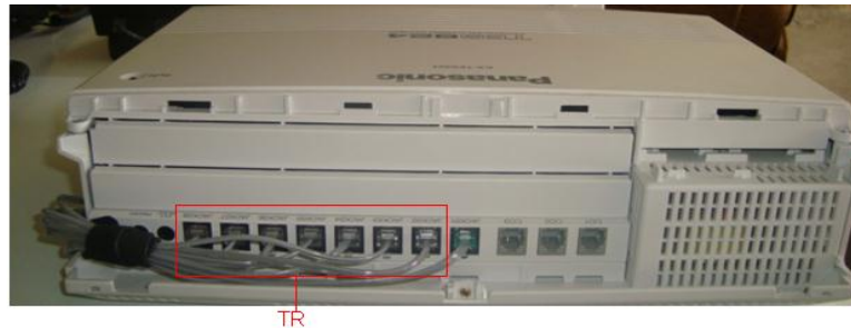
Fig.17 Ubicación de los jacks para los teléfonos regulares.
