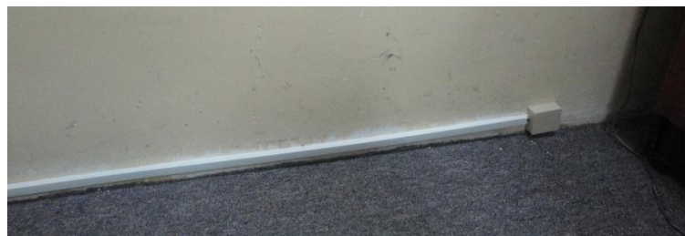
Fig.28 Cajetín (RJ11) sobrepuesto y canaleta colocado en la sala de profesores del Nivel técnico
