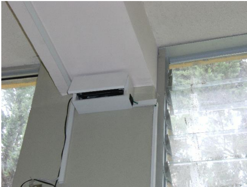
Figura 22: Cajas de protección para los transformadores de los Access Point
