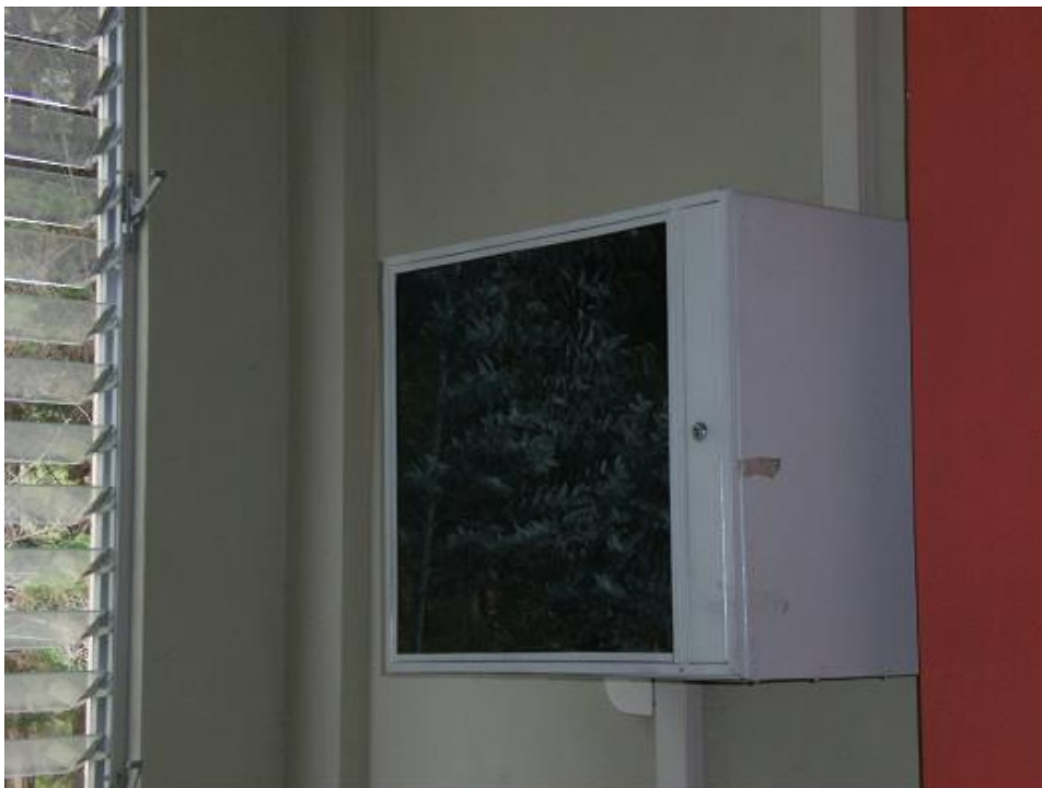
Figura 20: Armario de Telecomunicaciones
