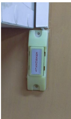
Figura 9.10. Pulsador de Emergencia
