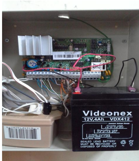
Figura 9.3. Gabinete Metálico/Central de Alarma/ Transformador de Corriente/ Batería
