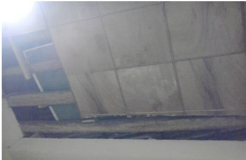
Figura 24. Desprendimiento del playwood
