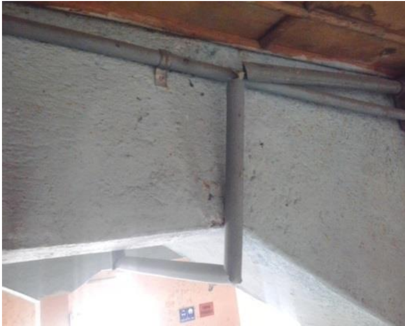
Figura 29. Parte de la tubería de circuito de iluminación desprendida , sin conectores en los ángulos y codos.
