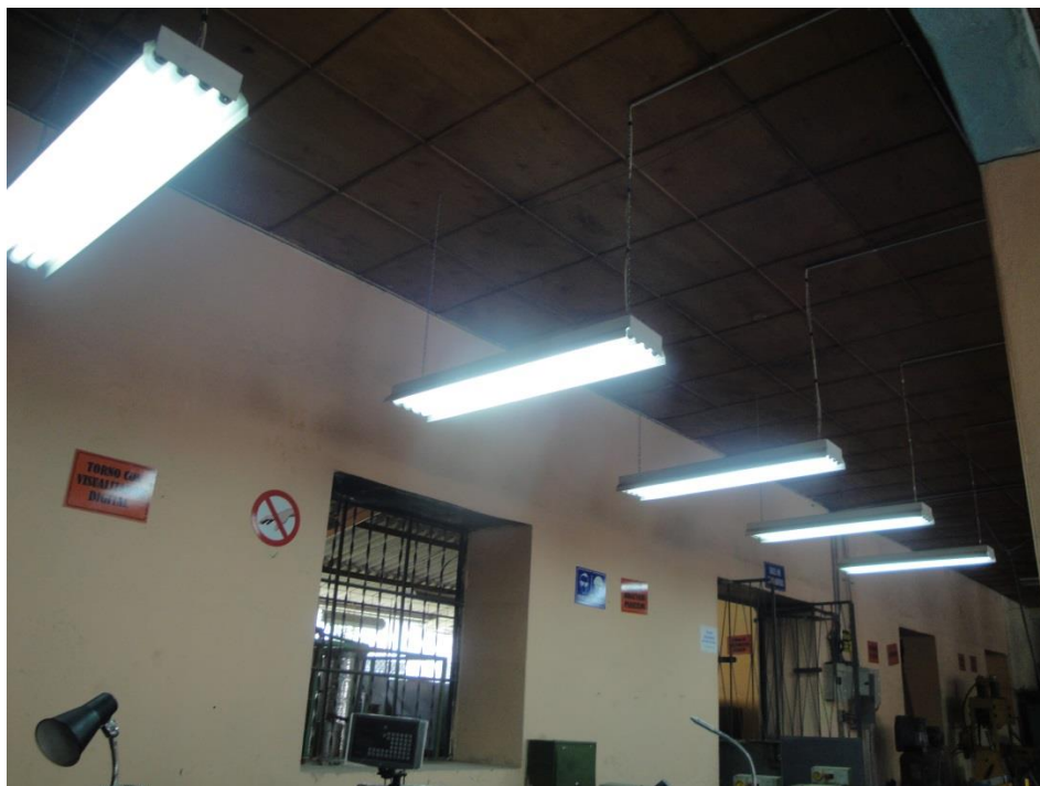
Figura 40. Luminarias en funcionamiento, área de tornos
