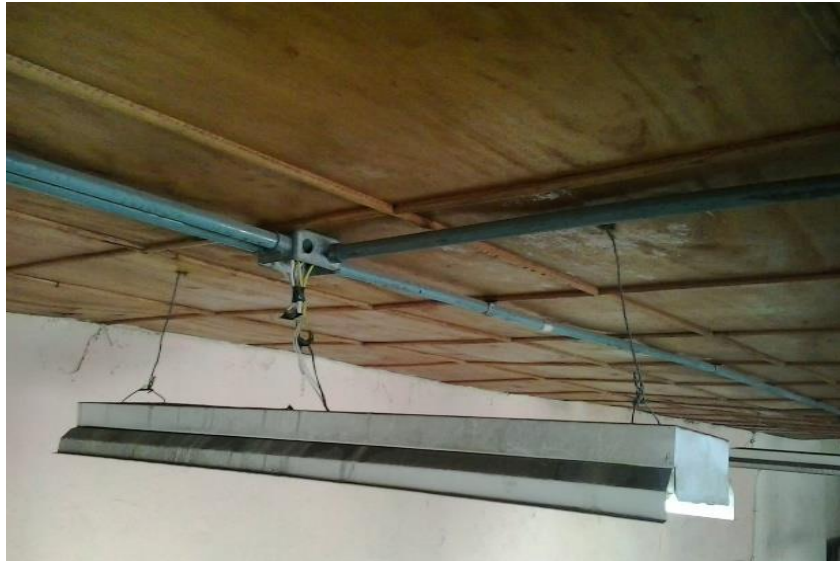
Figura 32. Caja de distribución desordenada y tubería de alimentación cruzada.
