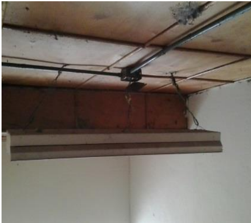
Figura 30. Cajas de paso sin tapas y cables visibles
