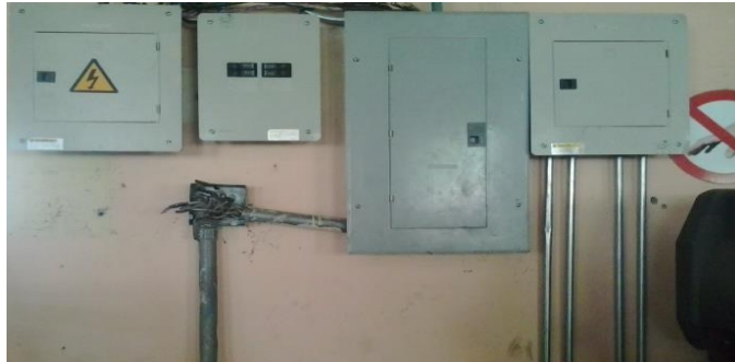
Figura 2. Estación de tableros de distribución.
