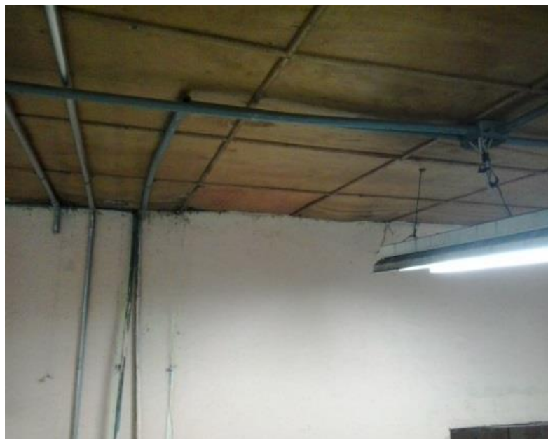
Figura 28. Partes de la tubería del circuito de iluminación desprendida sin codos, conectores y cajetines de paso o empalmes, sin tapas con los cables colgando sin conectores adecuados en sus respectivas uniones.
