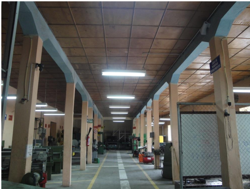
Figura 42. Luminarias en funcionamiento del pasillo entrada principal al taller
