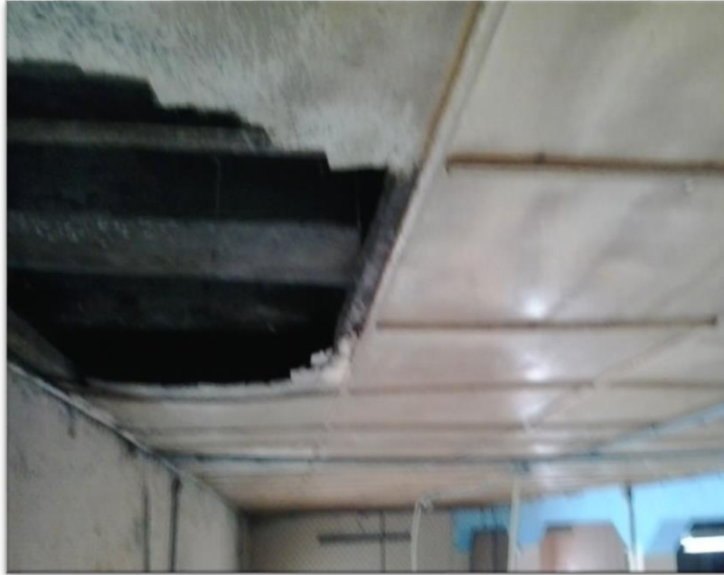
Figura 24. Tumbado parcialmente destruido
