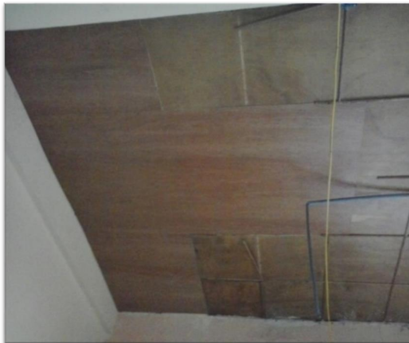
Figura 26. Área del tumbado reparado
