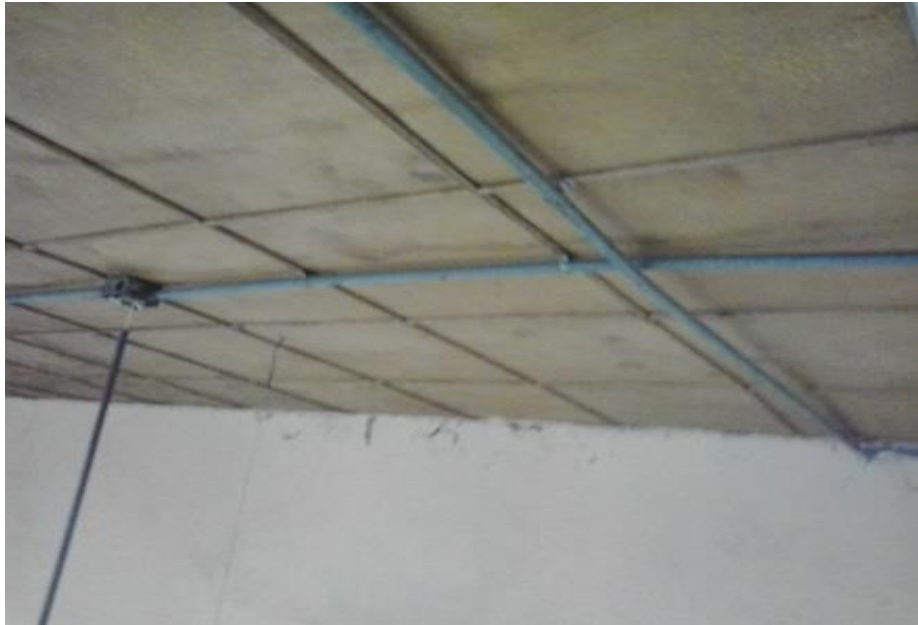
Figura 31. Tuberías de circito de iluminación y de fuerza sobrepuestas
