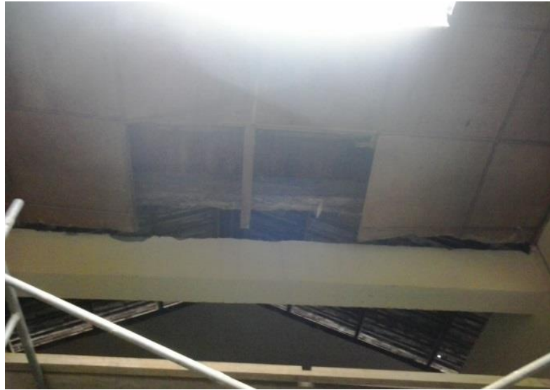
Figura 25. Parte del tumbado deteriorado
