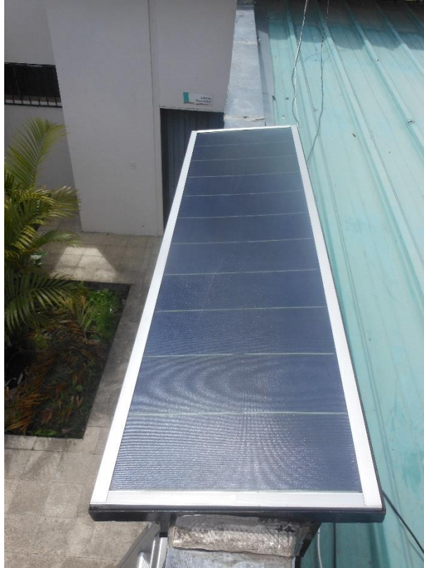
Fig. 20 (panel fotovoltaico y su estructura metálica de soporte.) Fuente: Autor
