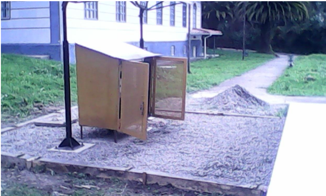
Estado final del sistema de generación fotovoltaico.
