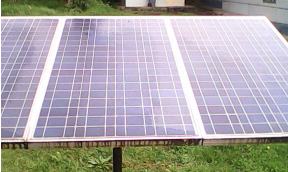
Paneles fotovoltaicos existentes.
