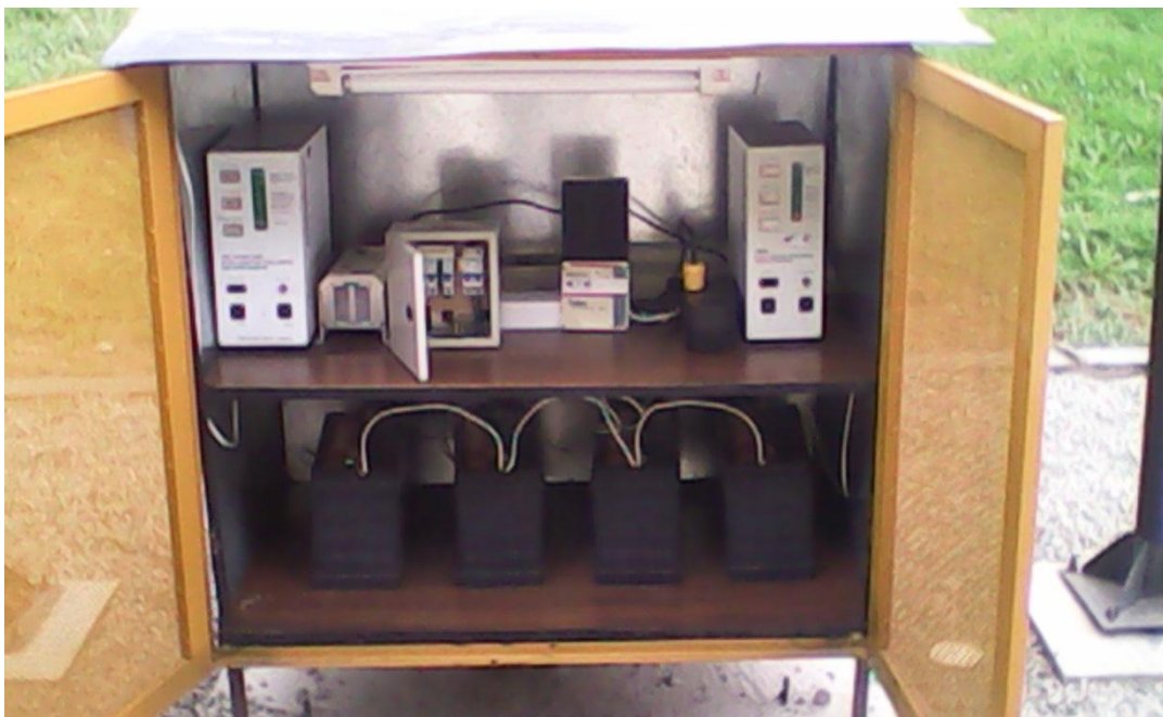
Instalaciones del sistema fotovoltaico actual.
