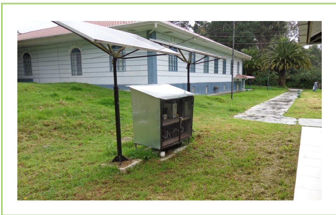
Figura 16. Estado anterior del sistema de generación FV
