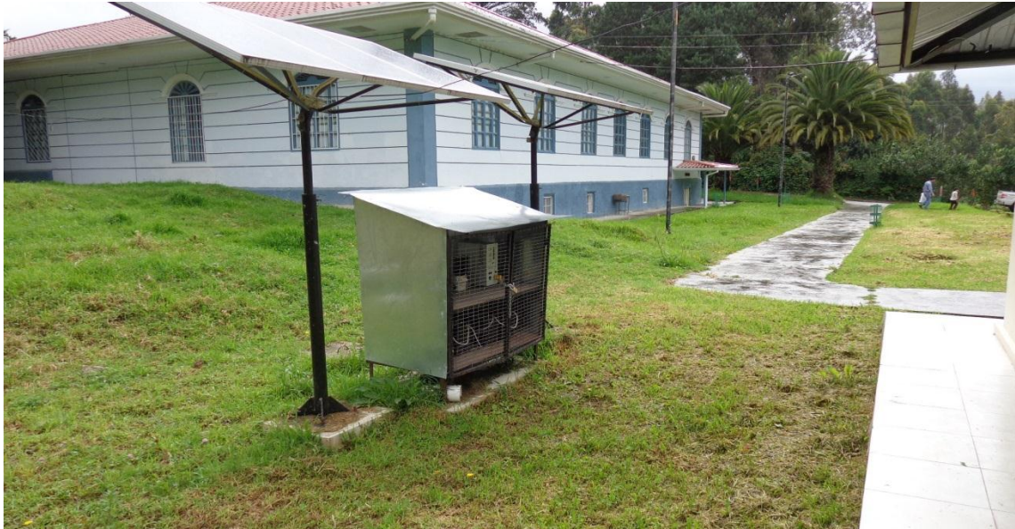
Estado inicial del sistema de generación fotovoltaico.
