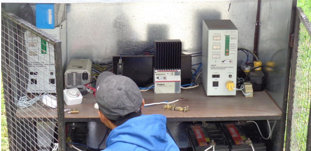
Instalaciones del sistema fotovoltaico anteriores.
