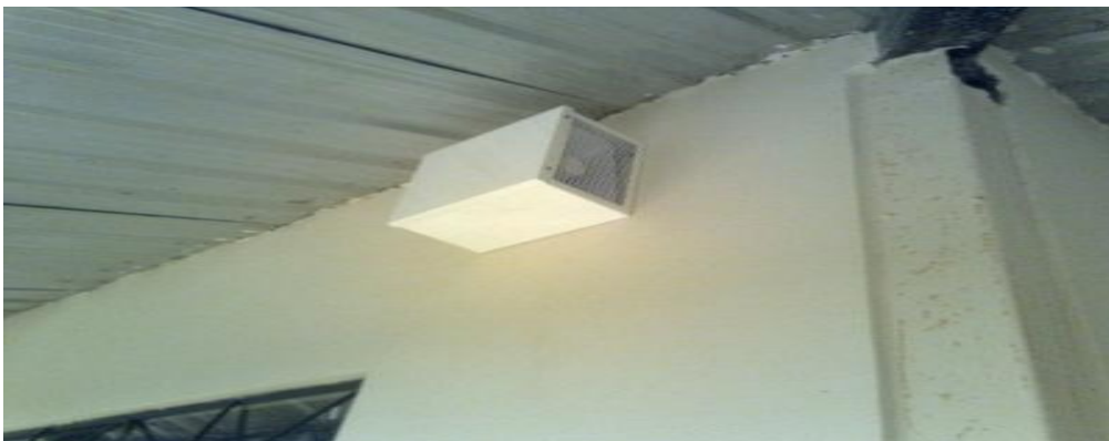
Fig. 19 Colocación de sirena
