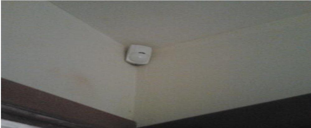
Fig. 22 Colocación de sensor movimiento oficina 1
