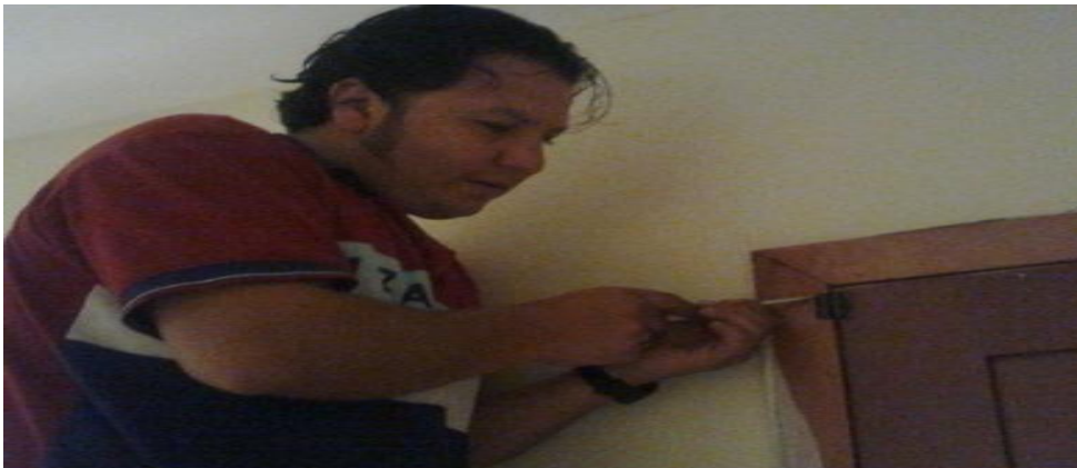
Fig. 26 Colocación de contacto magnético puerta posterior
