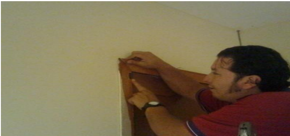
Fig. 25 Colocación de contacto magnético puerta principal
