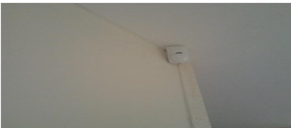
Fig. 24 Colocación de sensor movimiento sala de reuniones
