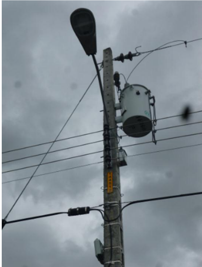
Anexo 4: circuito de baja y media tensión aéreo, colación de placa numérica, y recolección de información del transformador.
