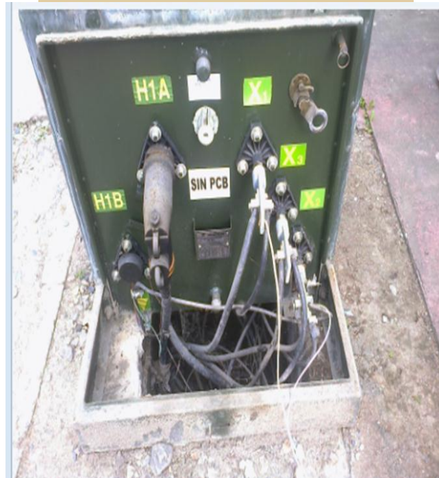
Anexo 8: Circuito de baja y media tensión subterráneo, colación de placa numérica, y información.
