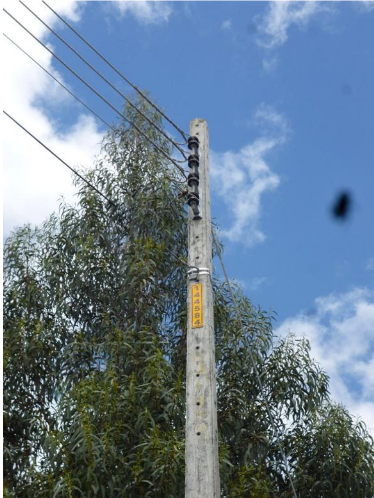
Anexo 3: circuitos de baja tensión aéreos, colocación de placa numérica y recolección de información.
