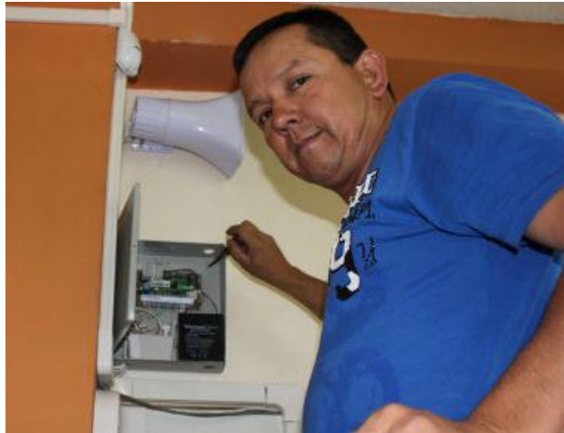
Fig. 21 Central de alarmas
