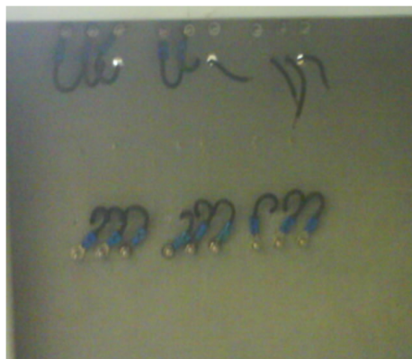
2. Conexiones internas de los contactores.
