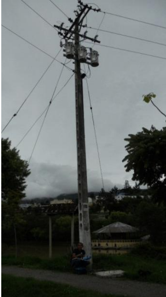
Figura 5.3. Banco de transformadores trifásicos
