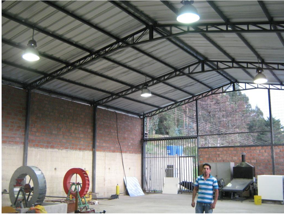
Fig. # 15. COMPROBACION DE LAS LUMINARIAS
