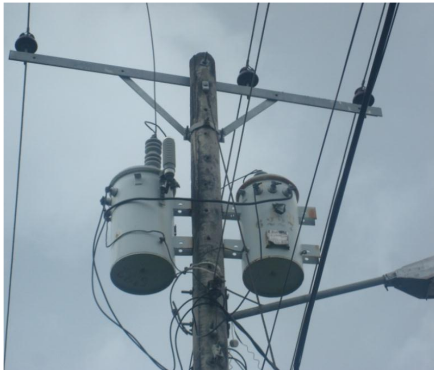
Figura 3.1 Banco de transformadores.
