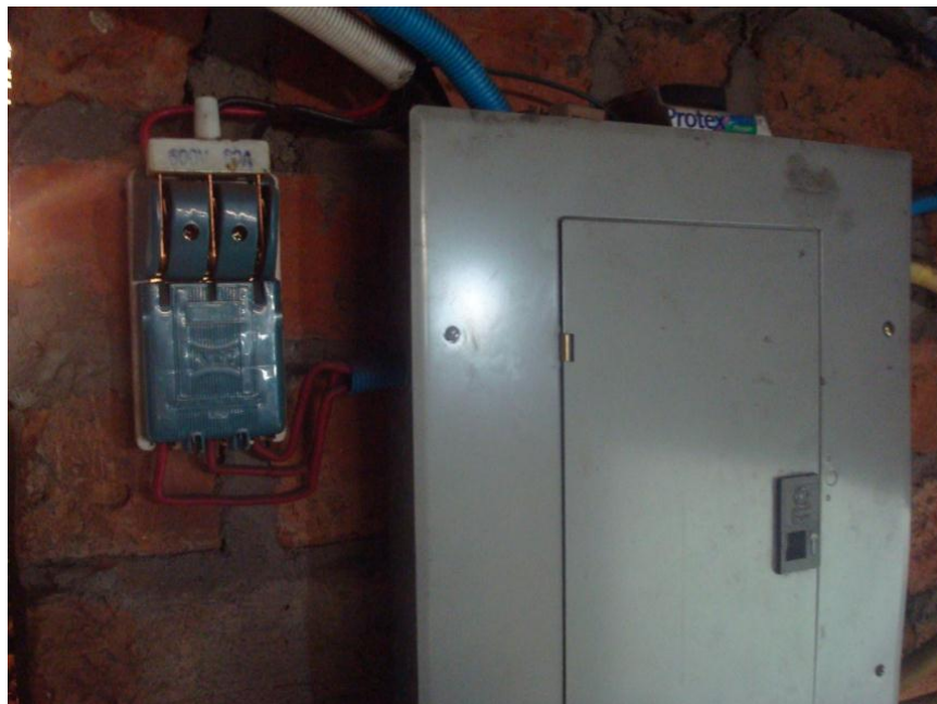
Figura 3.2 Subtablero de distribución
