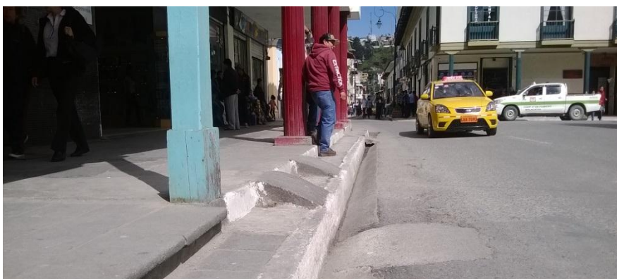
Rampas dentro del casco urbano de la ciudad con medidas y dimensiones fuera de las normas técnicas requeridas
