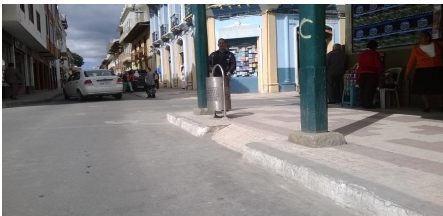
Rampas dentro del casco urbano de la ciudad con medidas y Diseño y dimensiones de rampas de fuera de las normas técnicas requeridas
