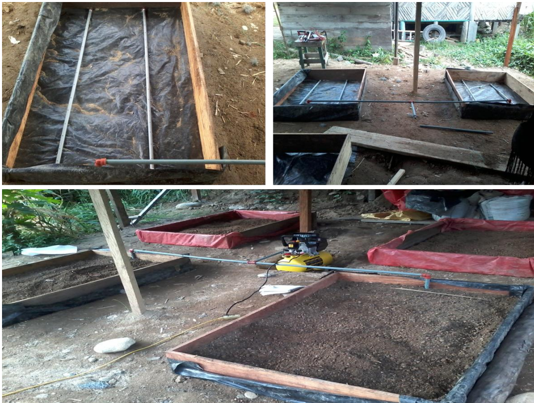
Fotografía 5. Sistema de aireación en funcionamiento.
