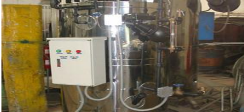
Grafico Nro. 26 CALDERA ELECTRICA
