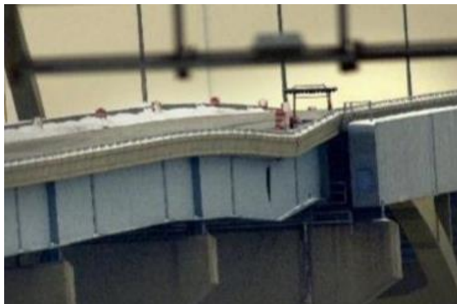
Figura 3. Fallo de una parte de un puente ocasionado por fatiga (11).
