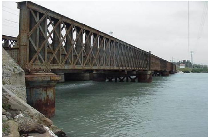
Figura 4. Corrosión general presente en puentes (12).
