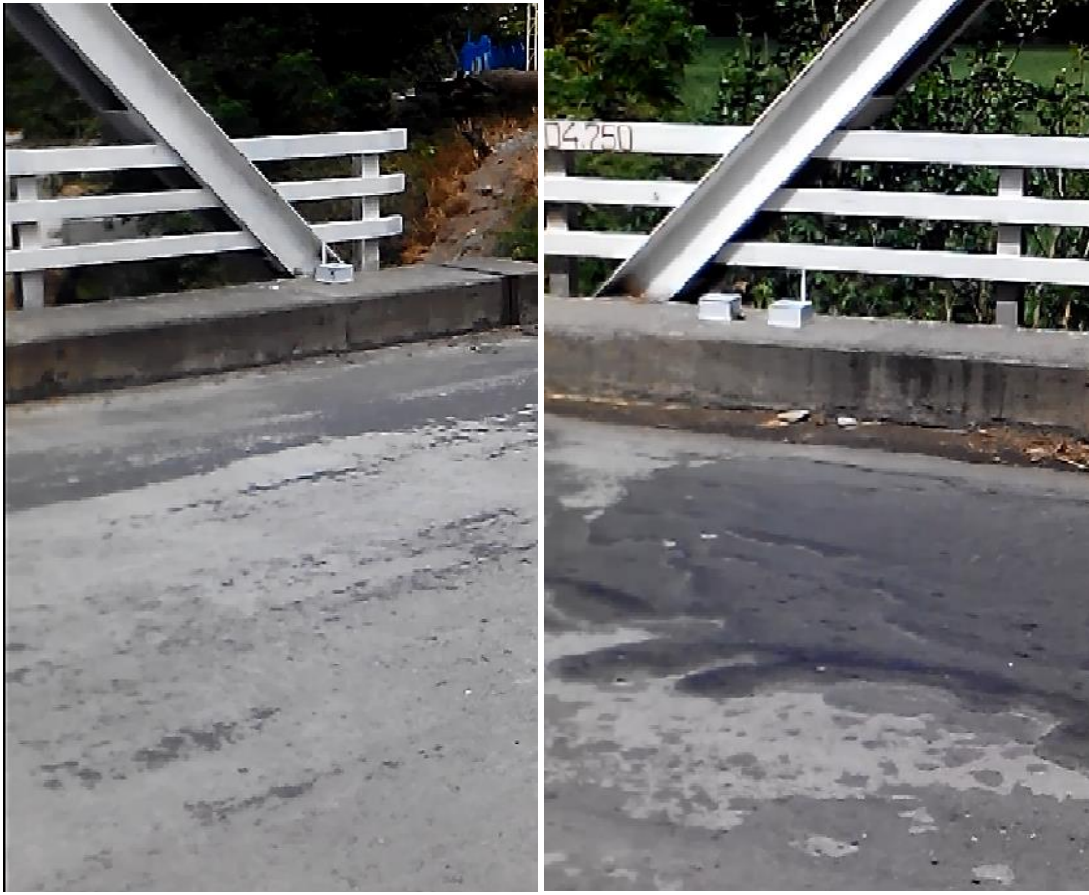
Figura 70. Ubicación de los nodos sensores 1, 3 y 4 sobre la estructura para su monitoreo. Vistos de izquierda a derecha.
