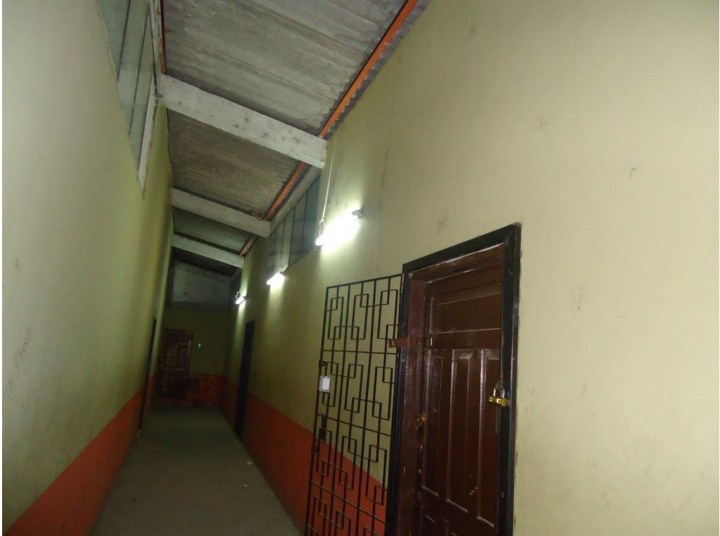
Ilustración 65: Ubicación del rack tercer piso B3
