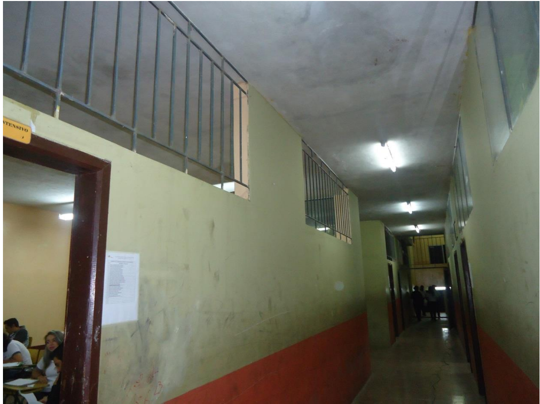
Ilustración 67: Ubicación del rack primer piso B3
