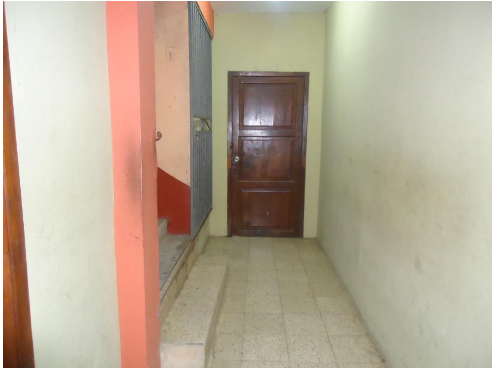
Ilustración 61: Ubicación del rack segundo piso B1
