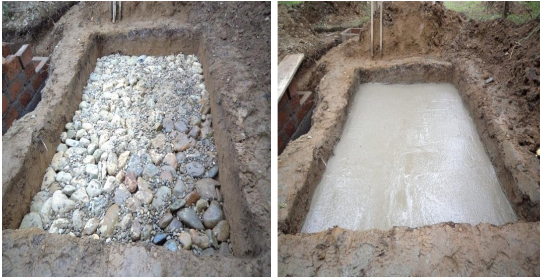
Fotografía 24. Cimentación de la loza de concreto del lecho de secado de lodos
